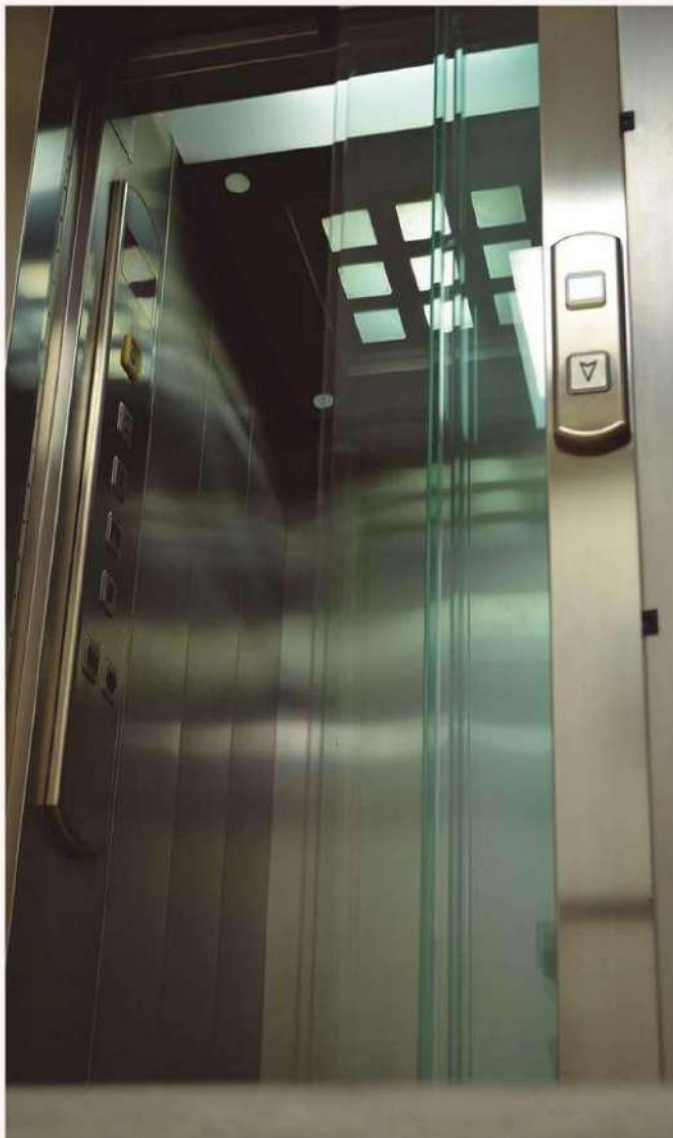
PANELES DE ACERO CON PUERTAS DE CRISTAL
